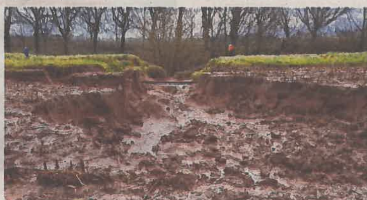
En février 2021, la crue de la Garonne avait ouvert en deux la digue Preignac-Toulenne. ARCHIVES « SO »
